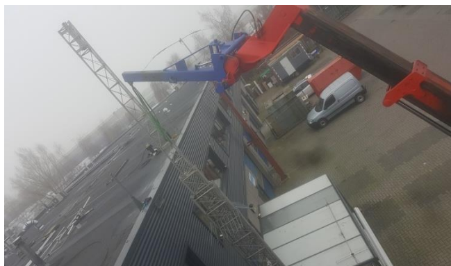
Het topdeel van de mast werd uit de overige delen van de mast gehesen. Het topdeel van de mast werd begin december uit de overige delen van de mast gehesen.
